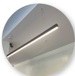
Luminárias de teto
